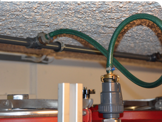
Das Absaugen der Gase an der Quelle zusammen mit einer zusätzlichen Raumbelüftung bietet die grösste Sicherheit.
