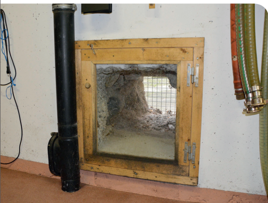
Eine natürliche Lüftung ohne weitere Massnahmen ist in der Regel nicht ausreichend während der Gärphasen.
