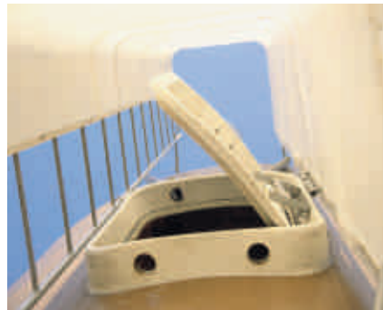
Siloluken müssen sich nach aussen öff- nen lassen, die Leiter rutschfest und der Schacht gut durchlüftet sein. Nach innen öffnende Luken sind äusserst gefährlich, weil die Durchlüftung erschwert ist.
