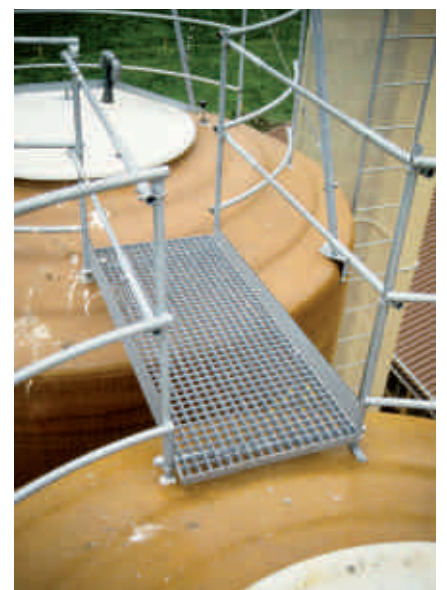
Nebeneinander stehende Silos von gleicher Höhe müssen mit Laufstegen verbunden sein.
