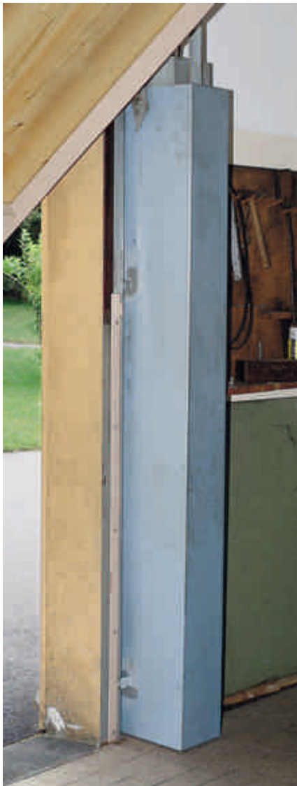
Gegengewichte oder Federn von Toren müssen so eingebaut oder verkleidet werden, dass sie niemanden gefährden.
