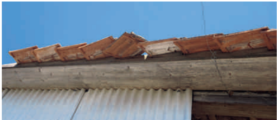
Gefährliche Gebäudeteile müssen beseitigt oder gesichert werden. Lose Ziegel sollten sofort befestigt werden.
