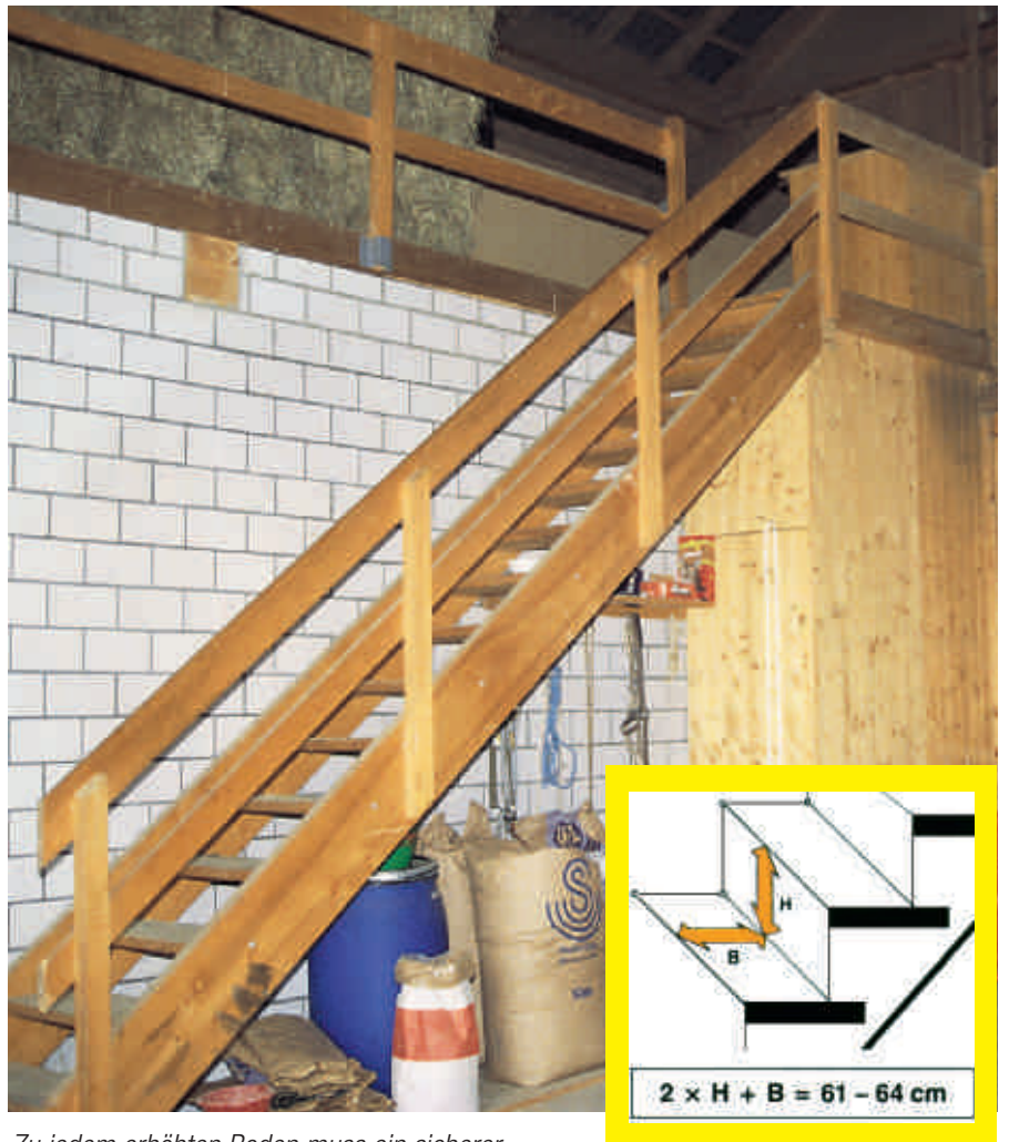
Zu jedem erhöhten Boden muss ein sicherer Aufgang erstellt werden. Dieser ist grundsätzlich in Form einer Treppe zu errichten. Das Treppenstufenverhältnis muss immer innerhalb der vorgegebenen Formel liegen, damit die Treppe sicher begangen werden kann.
