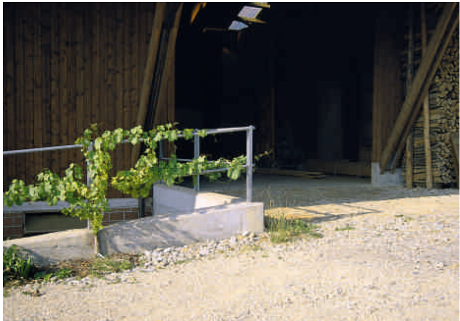
Einfahrten sollen nicht zu steil sein und wenn Absturzgefahr besteht, müssen sie mit Geländern und massiven Radabweisern ausgerüstet werden.
