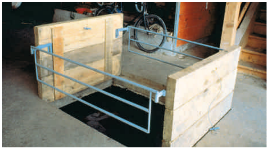
Sicherung der Bodenöffnung in einer Durchfahrt.
