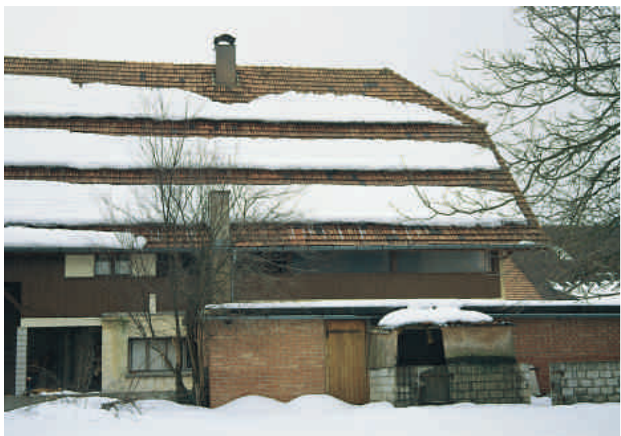
Durch Anbringen von Dachrechen oder Schneestopperrn werden Personen und fremde oder eigene Autos durch Dachlawinen nicht gefährdet. Für derartige Unfälle ist der Bauer als Gebäudeeigentümer haftbar.
