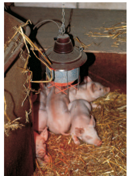
Wärmestrahler müssen an einer Kette aufgehängt und mit einem Schutzkorb versehen sein. Ein FI-Schutzschalter erhöht die Sicherheit.
