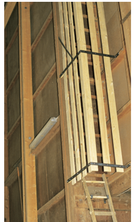
Un accès au tas de foin avec protection dorsale, nécessaire dès une hauteur totale de 5 m.
