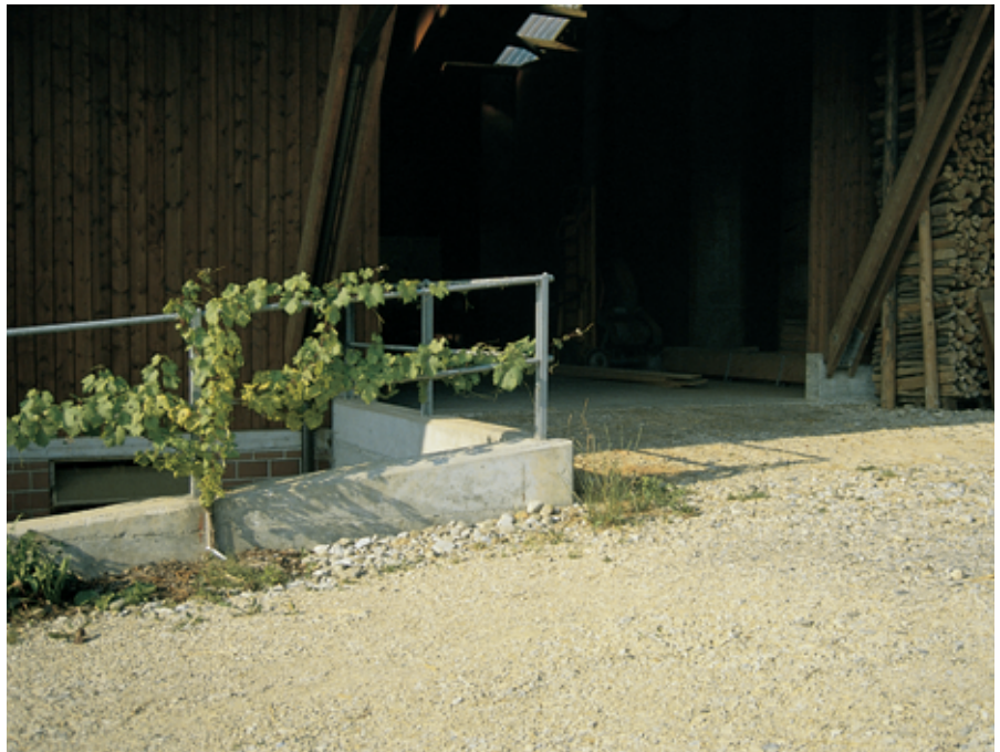
Les voies d'accès carrossables ne doivent pas avoir une pente excessive; il faut les border d'une barrière robuste et d'une bordure en béton lorsqu'un risque de chute existe.
