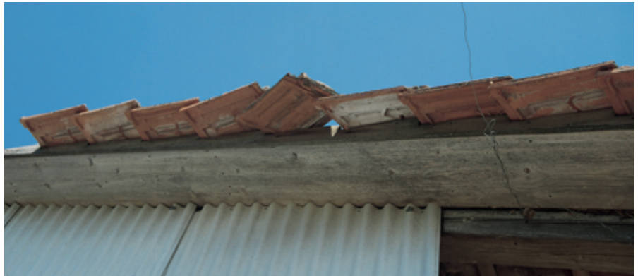
Les parties dangereuses des bâtiments doivent être éliminées ou assurées. Il faut fixer immédiatement les tuiles décrochées.
