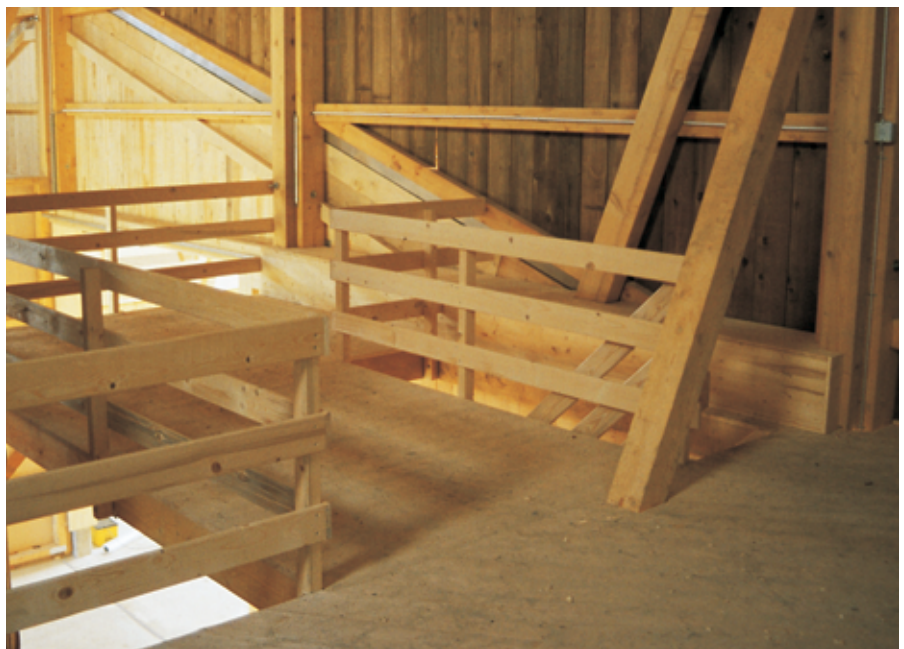
Toutes les plates-formes surélevées et les passerelles doivent être sécurisées par des balustrades. Un bon exemple avec barrières et main-courante.
