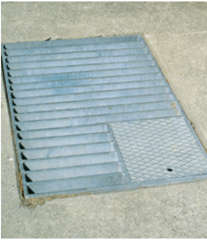
Grille carrossable avec une petite ouverture pour le tuyau de prélèvement.
