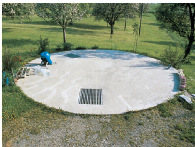
Les fosses à lisier fermées doivent être munies de deux ouvertures d'aération suffisamment grandes, disposées en diagonale.
