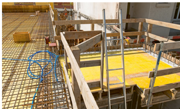
14 Scala che sporge 1 m oltre il bordo e garantisce un accesso sicuro.
