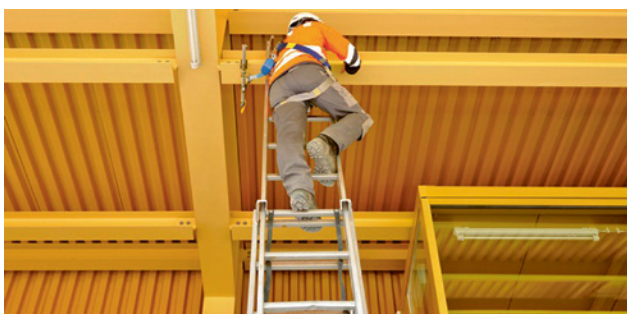
33 Persona messa in sicurezza con un'imbracatura anticaduta (punto di ancoraggio sopra la testa)
